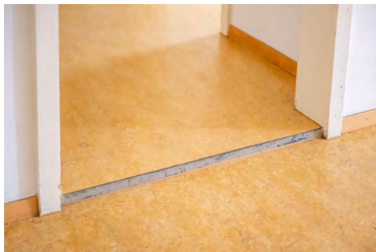
Schwelle mit PVC Belag
