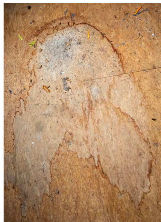
Feuchtigkeitsspuren am Boden
