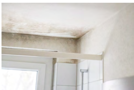
Schimmelspuren im Badezimmer
