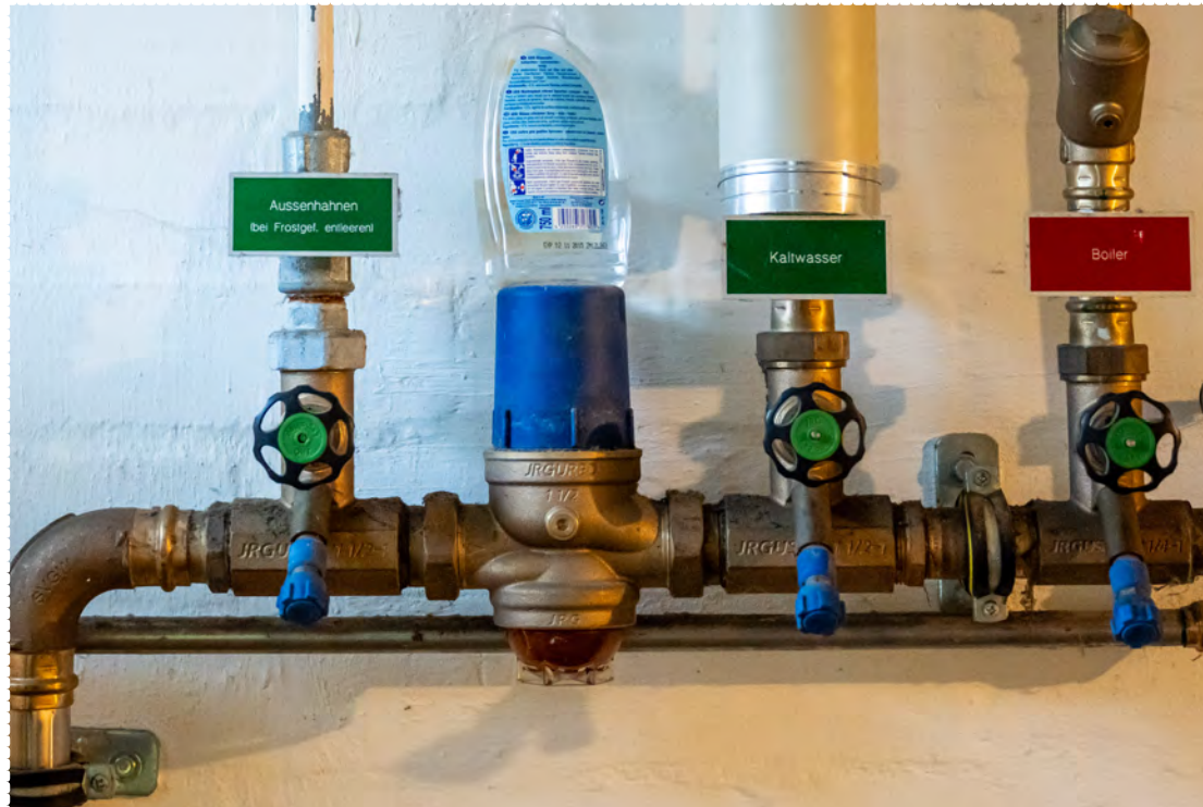
Gebäudetechnik: Warm- und Kaltwasserverteilung
